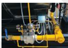
Tren de Gas SIEMENS
