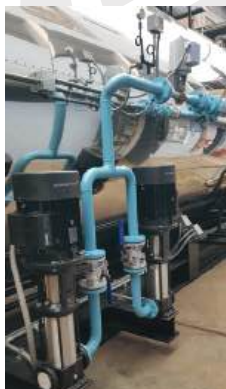
Sistema de Alimentación Continua de agua SIEMENS
