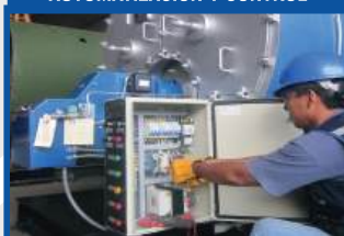
AUTOMATIZACIÓN Y CONTROL
